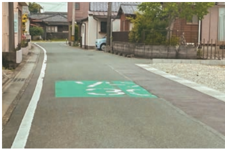
規制標示が一部消えている通学路
