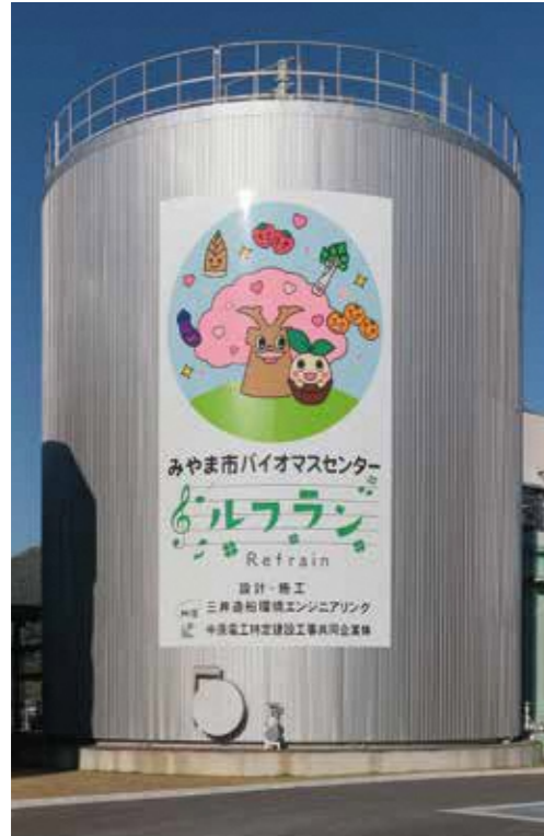
メタン発酵槽
