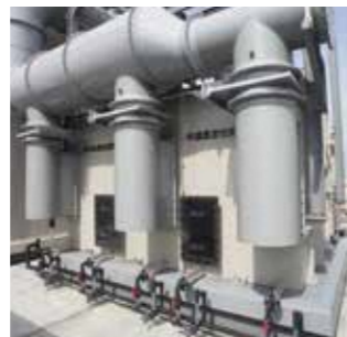
活性炭脱臭塔
