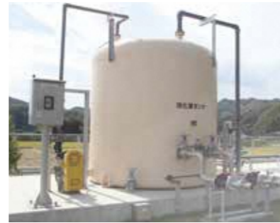
消化液タンク
