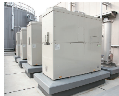
バイオガス発電機
