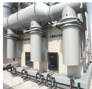
活性炭脱臭塔
