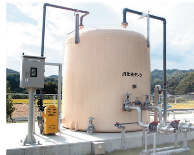
消化液タンク
