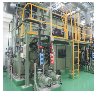
生物脱臭塔・薬液脱臭塔
