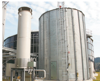
ガスホルダ・余剰ガス燃焼装置
