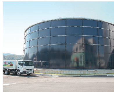
消化液貯留槽
