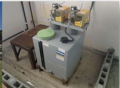
次亜塩素酸ナトリウム注入設備
