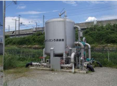
除マンガンろ過施設
