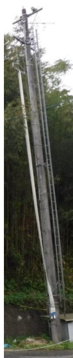
電柱式 乾燥塔
