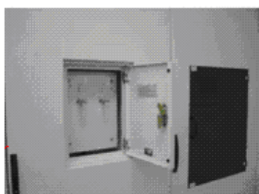
消防用無線機接続端子（内部）
